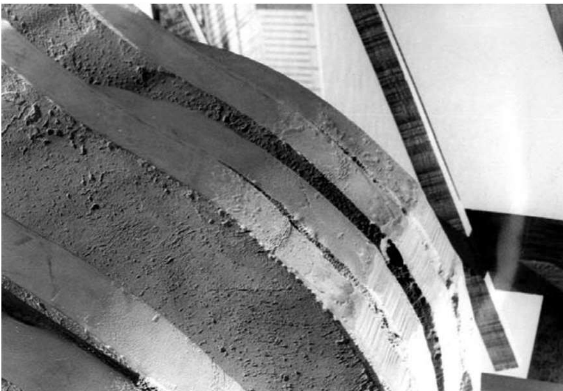
Figura 2. Aspecto típico de los ojales examinados. Se notan los defectos superficiales característicos del doblado de conformación mecánica, presentes en varias regiones de los ojales.
